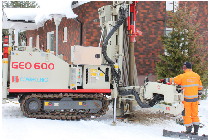
Maalämpöjärjestelmän toimivuuden kannalta keskeistä on maalämpökaivon pituuden ja kaivon kytkettävän lämpöpumpun oikea mitoitus. Parhaimmillaan nykytekniikalla päästään jo siihen, että yhdellä järjestelmään käytetyllä sähköenergiapanoksella tuotetaan viisinkertainen määrä lämpöenergiaa.
